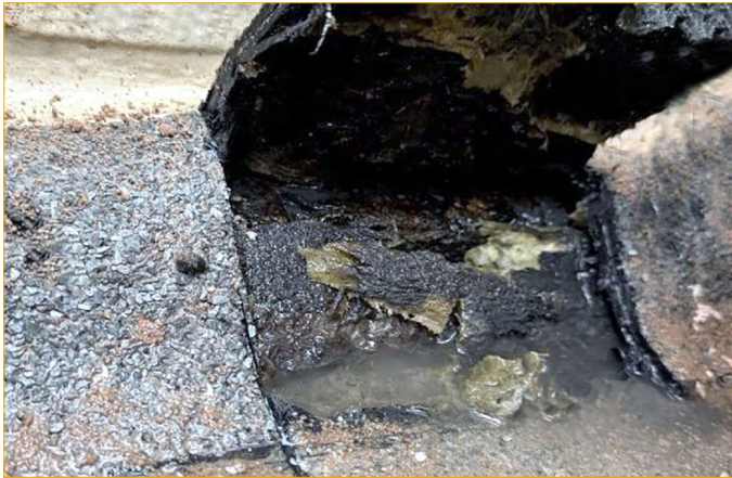
Abb. 02: Bauteilöffnung, stehendes Wasser und sandige Ablagerungen unter der Abdichtungsbahn 7
