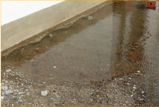
Abb. 01: Aufgestautes Niederschlagswasser vor dem Neubau
