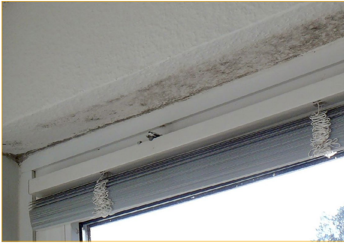
Abb. 01: Schimmelpilzbefall im Bereich der Fensterlaibungen
