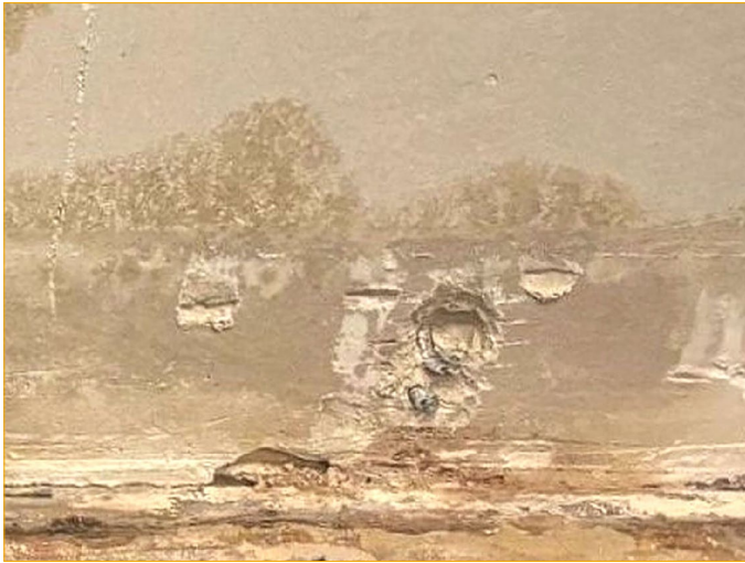
Abb. 02: Durchfeuchtete Wand im Fußpunktbereich
