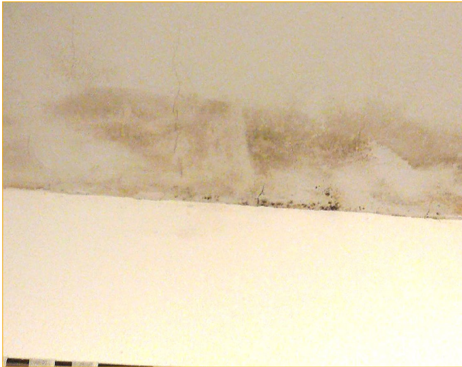
Abb. 03: Schimmelpilzbefall im Anschlussbereich Außenwand-Decke
