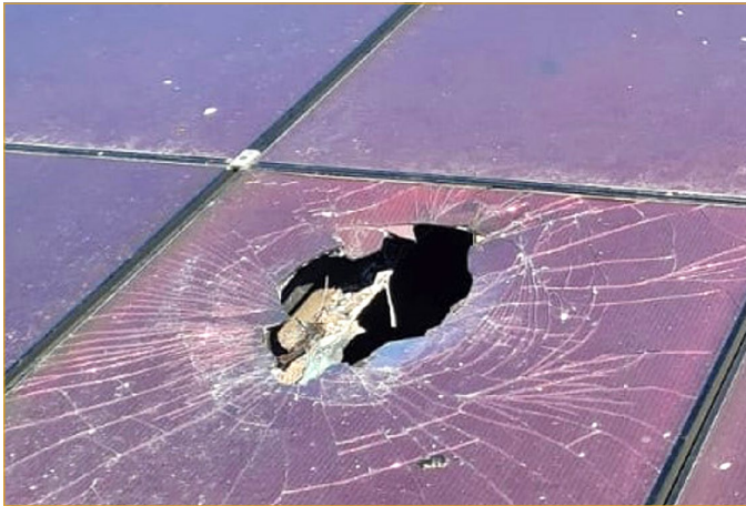
Abb. 01: Durch starke Hitzeeinwirkung beschädigtes PV-Modul
